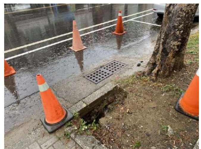
樹木棲地土壤掏刷
