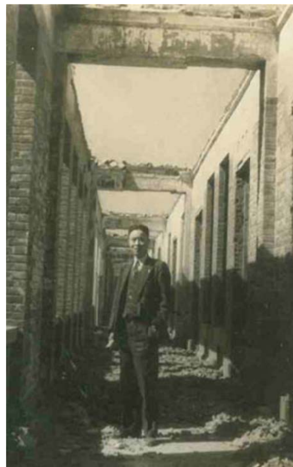
紅樓屋頂毀損之一【摘錄南大校史室】
