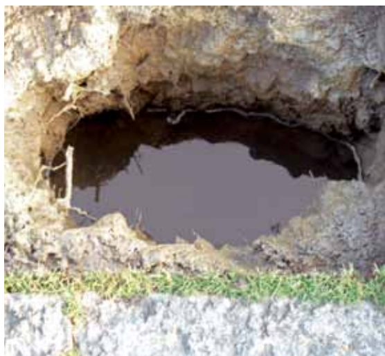
樹棲地因整地工程相當完備，所以造成排水不良。
