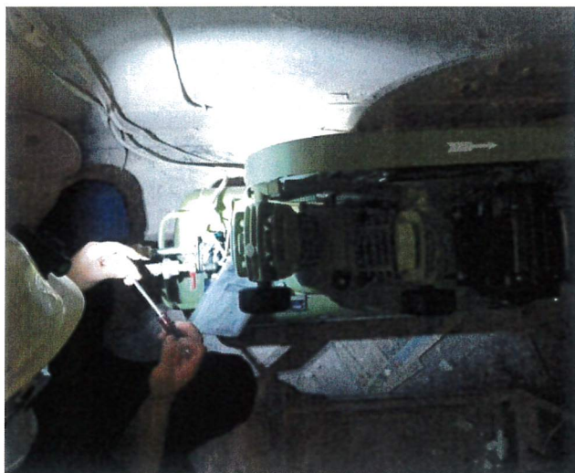
絕緣電阻值量測
