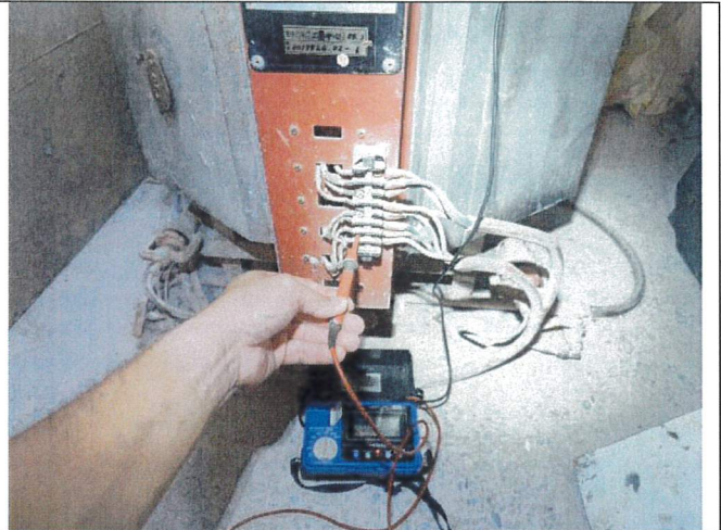
絕緣電阻值量測
